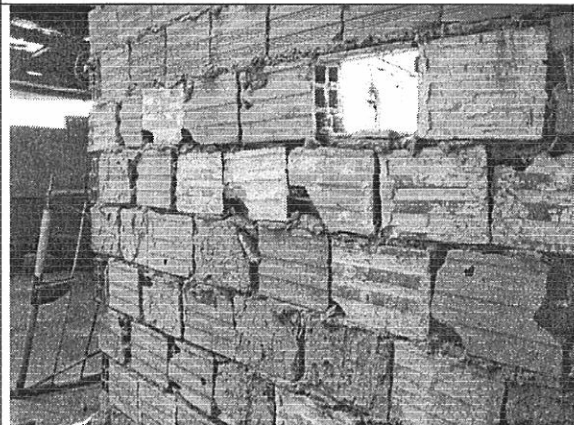
Foto 12. Mala calidad de la construcción
