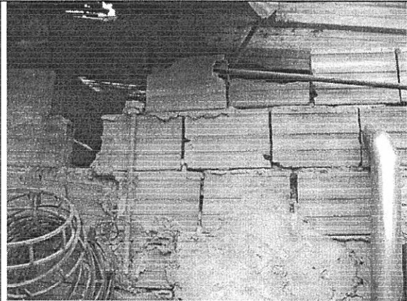
Foto 10. Desprendimiento de unidades de mampostería
