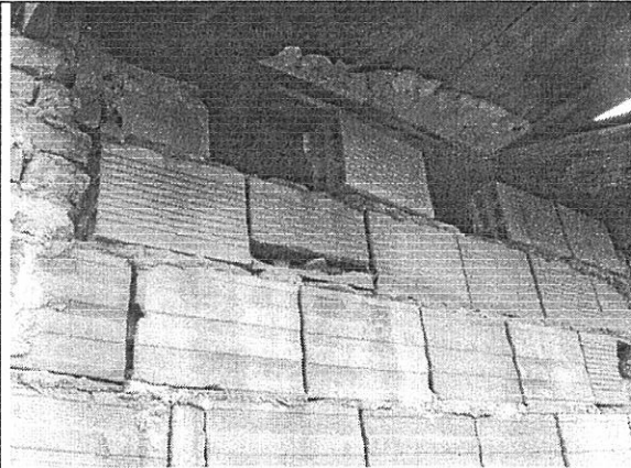
Foto 9. Deformación y pérdida de verticalidad en muros
