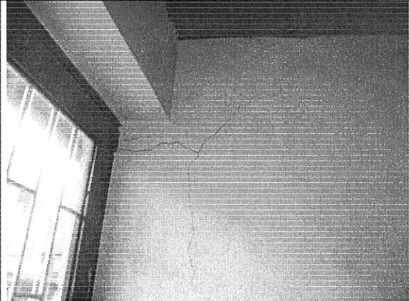
Foto 4. Agrietamiento en muros del sector frontal
