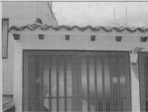
Foto 2. Daño severo en muros de fachada.
