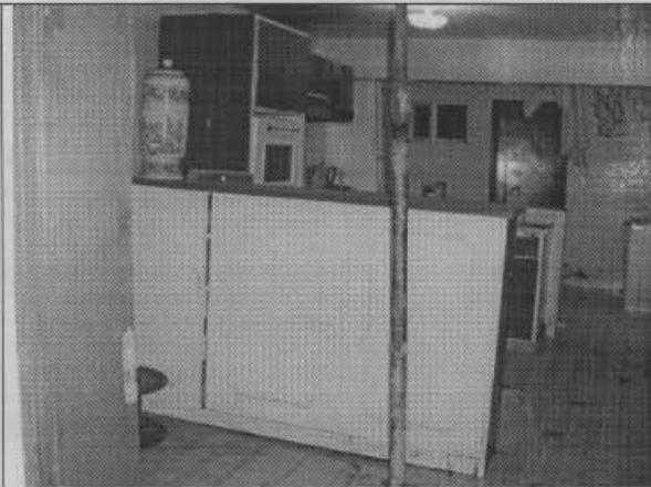
Foto 20. Desnivel de pisos por Asentamientos Diferenciales.
