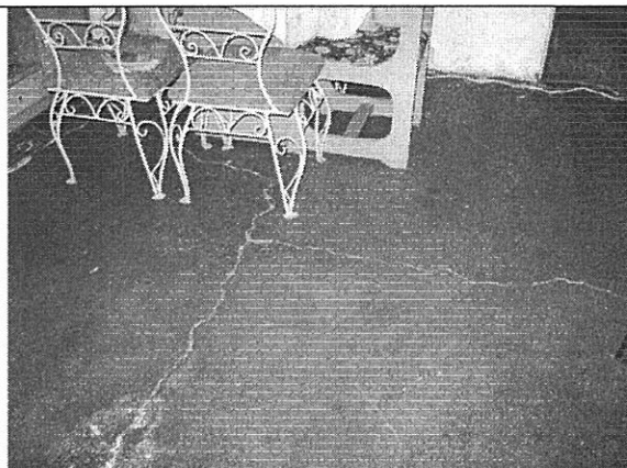
Foto 7. hundimientos y agrietamientos en el piso
