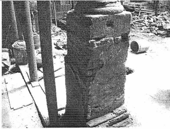
Foto 13. Apoyo original y apoyos provisionales.
