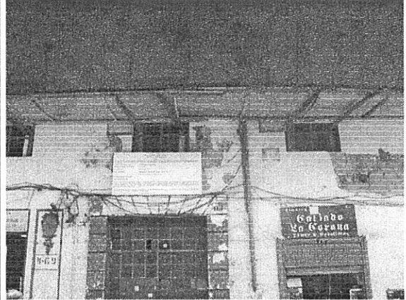
Foto 2. Desprendimiento del pañete de la fachada.
