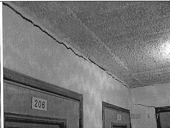
Foto 13. Separación entre muros y placa
