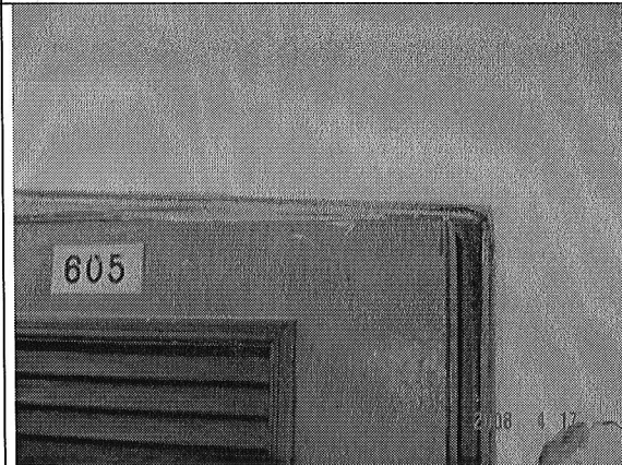
Foto 12. Deformación de los marcos de las puertas
