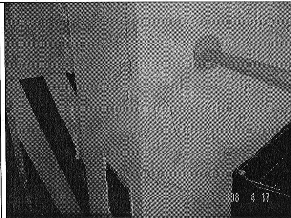
Foto 11. Muros del sótano con daño fuerte
