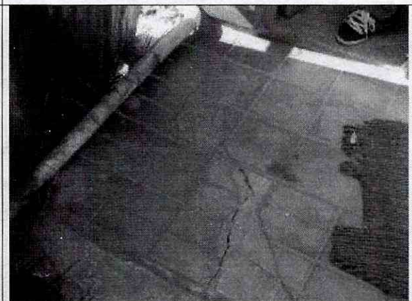
Foto 8. Agrietamiento en andén del acceso principal
