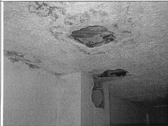
Foto 5. Daños en acabados de placas por humedad
