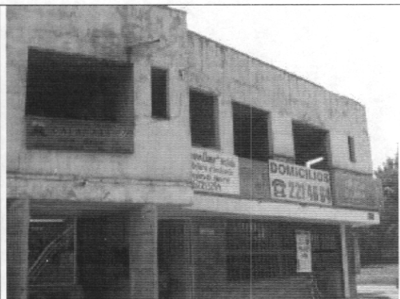
Foto 2. Fachada costado norte, deterioro de acabados
