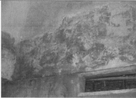
Foto 11. Humedad en muros costado oriental
