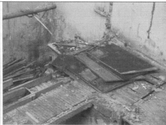
Foto 7. Entrepiso zona posterior en mal estado
