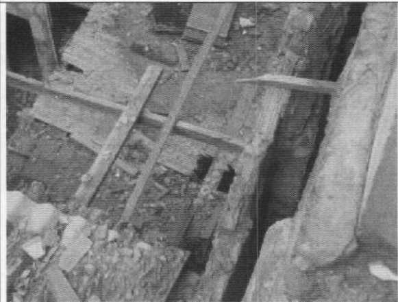
Foto 6. Colapso de entrepiso en madera
