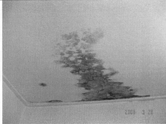
Foto 4. Humedad en el cielo raso
