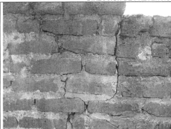
Foto 3. Agrietamientos del muro
