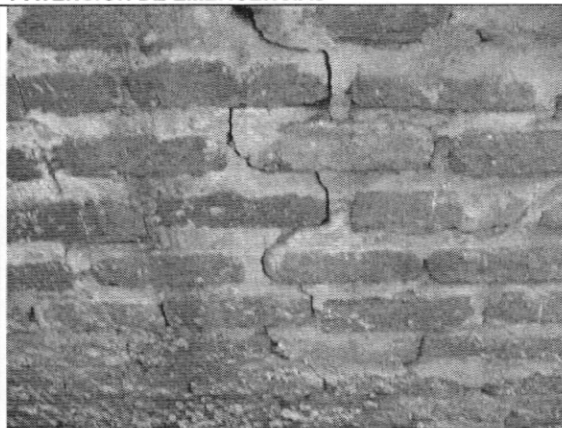
Foto 4. Agrietamiento que sigue la línea de pega
