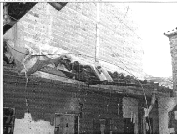
Foto 4. Daño fuerte en cubierta
