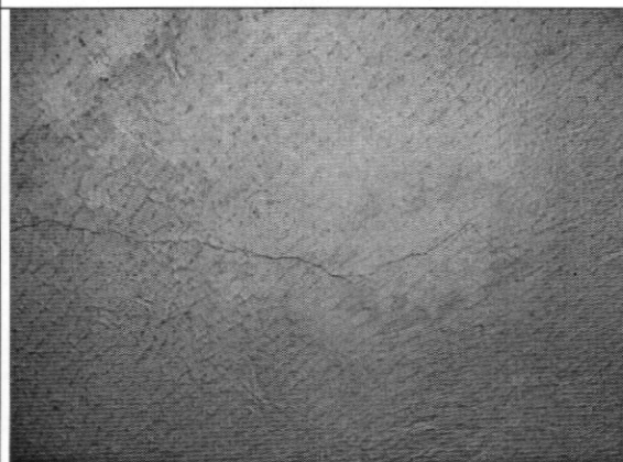
Foto 8. Humedad y agrietamiento en cielo raso
