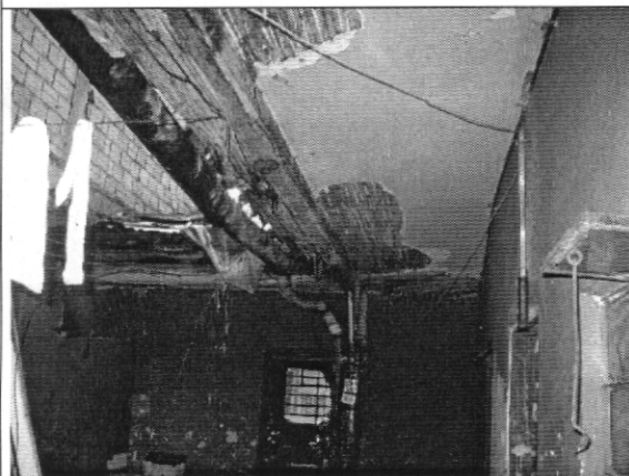
Foto 5. Daños en cubierta y cielo raso
