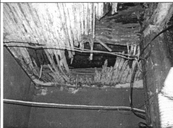
Foto 7. Colapso parcial del cielo raso
