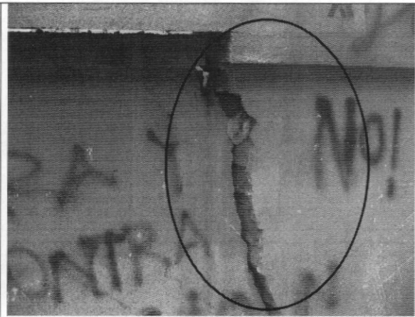
Foto 4. Grieta vertical en la parte central del muro
