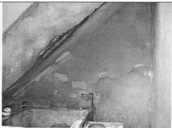
Foto 7. Daños en los acabados de los muros
