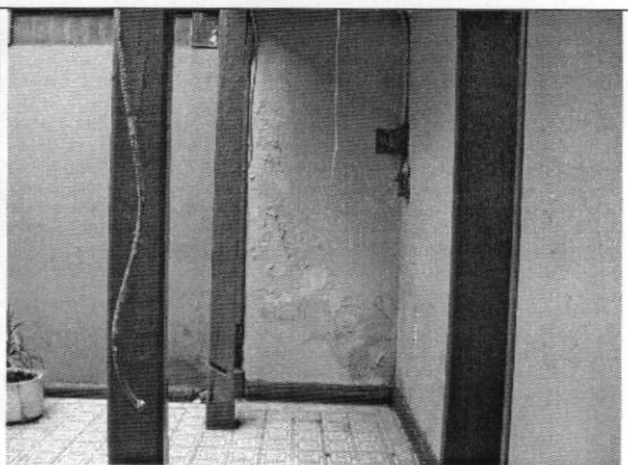
Foto 8. Daño en muros por humedad excesiva
