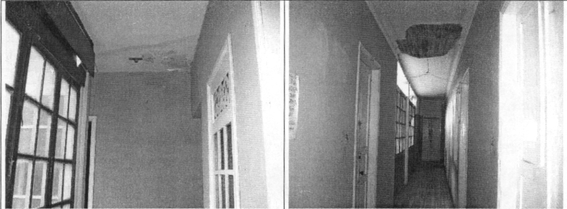
Foto 9. Cielo raso afectado por humedad
