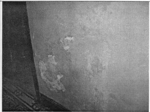
Foto 6. Desprendimiento de acabados
