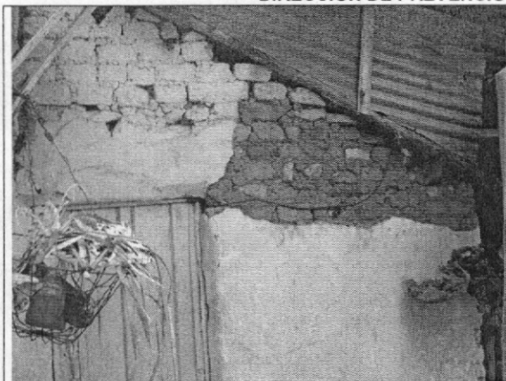
Foto 9. Daños en muros de la edificación central
