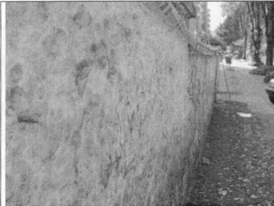
Foto 5. Se detecta pérdida de verticalidad pronunciada, con inclinación hacia el exterior del predio
