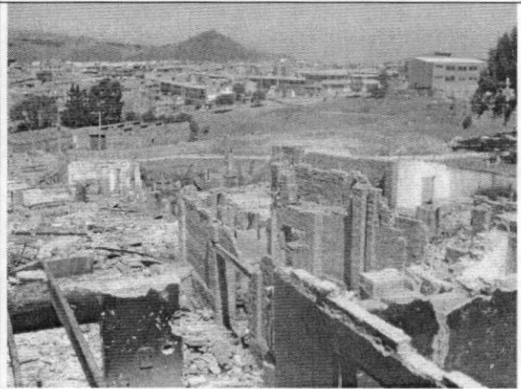
Foto 8. Muros inestables por demolición inconclusa
