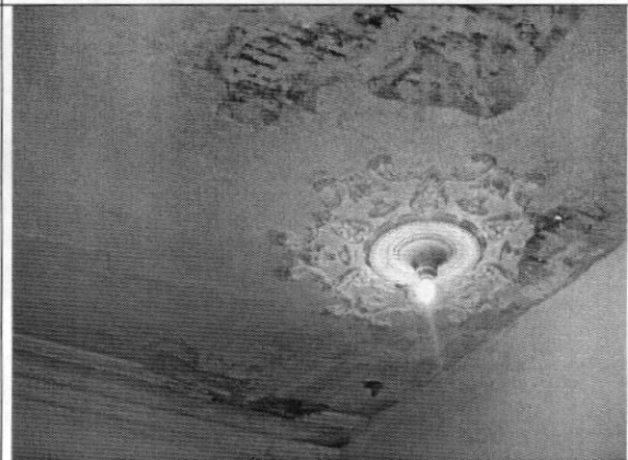
Foto 8. Humedad en cielo raso
