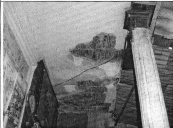
Foto 7. Desprendimiento de acabado del cielo raso
