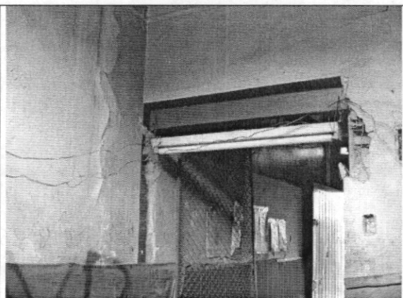
Foto 2. Muros internos con daños
