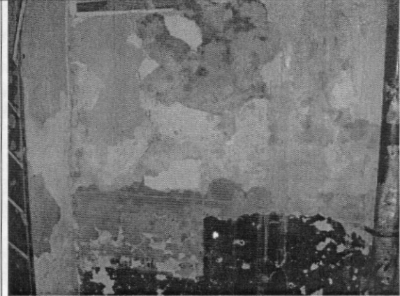
Foto 4. Desprendimiento del pañete de recubrimiento
