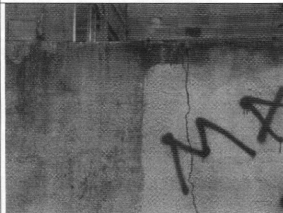
Foto 7. Grieta en muro de cerramiento, costado sur
