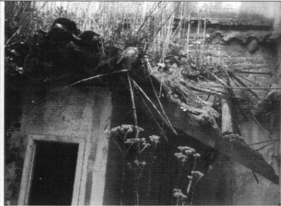
Foto 2. Muros de primer piso en mal estado
