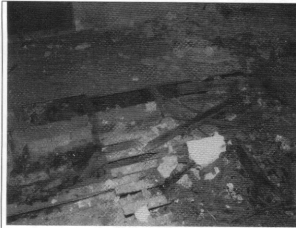
Foto 7. Piso en madera deteriorado
