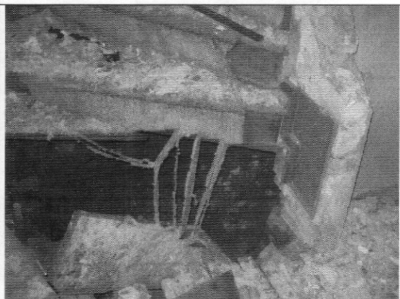
Foto 6. Escaleras en madera en malas condiciones
