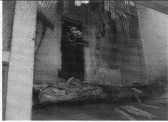
Foto 4. Colapso muros segundo piso
