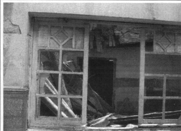
Foto 3. Colapso parcial de muros primer piso
