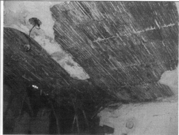
Foto 8. Colapso parcial de cielo raso
