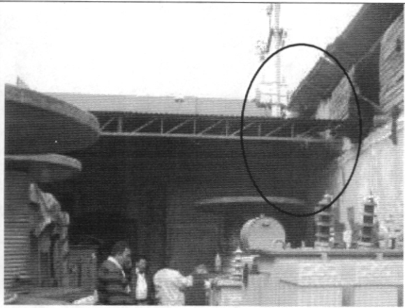
Foto 6. Cubierta zona frontal, apoyos deficientes
