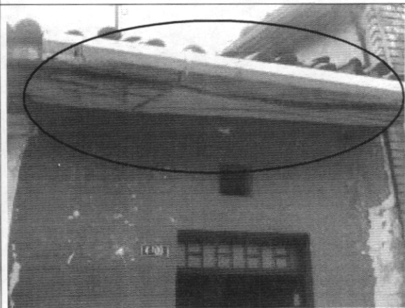
Foto 6. Alero frontal en mal estado
