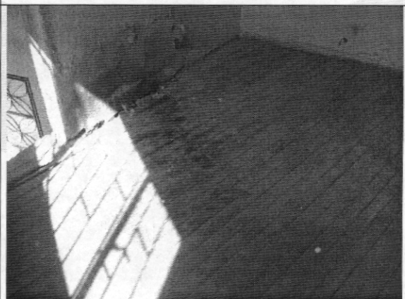
Foto 8. Entrepiso en madera con deterioro
