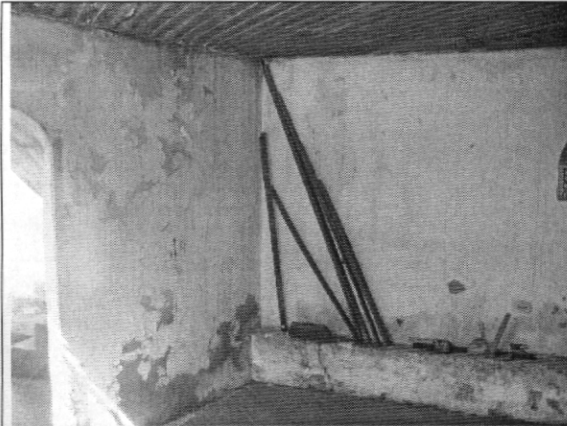
Foto 3. Deterioro de los acabados de muros internos
