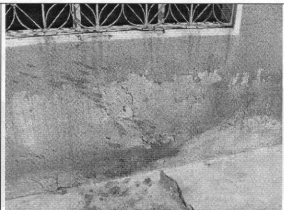
Foto 2. Muros externos con desprendimientos de acabados
