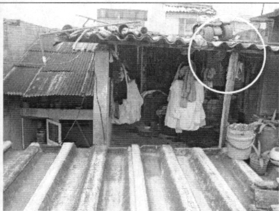
Foto 6. Cubierta del tercer piso, uniones deficientes
