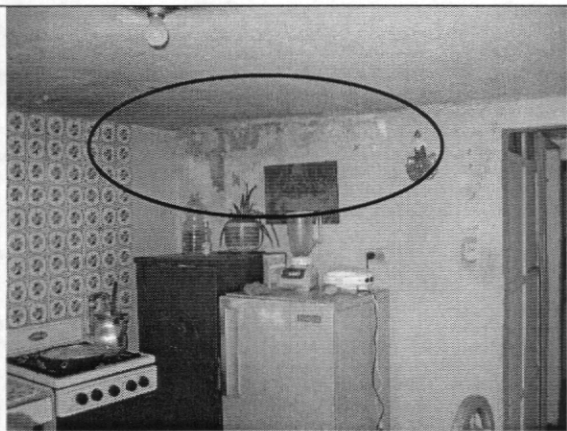
Foto 4. Deterioro por humedad en muros de segundo piso
