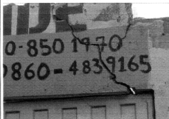
Foto 3. Grieta en parte superior muro, costado oriental
