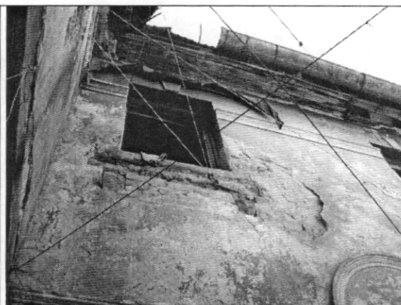
Foto 4. Desprendimiento de acabados
