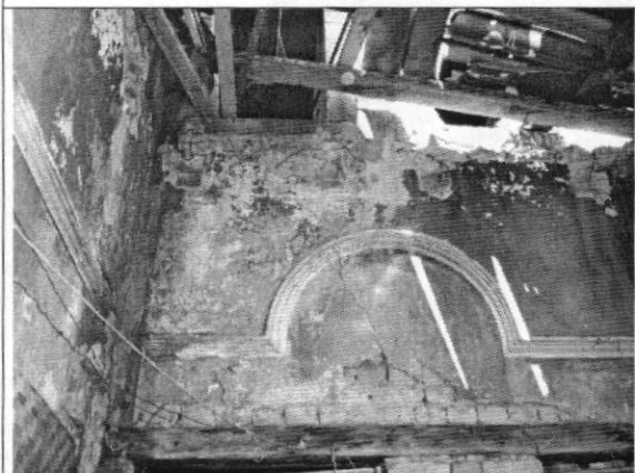
Foto 5. Muros internos con deterioro progresivo
