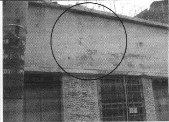
Foto 2. Fisura en parte superior del muro de fachada
