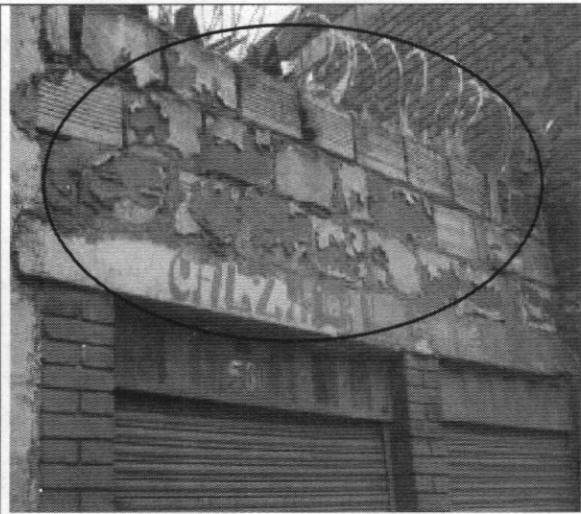
Foto 4. Bloques sueltos en la parte superior del muro
