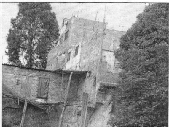
Foto 4. Placa de cubierta provisional sin concluir
