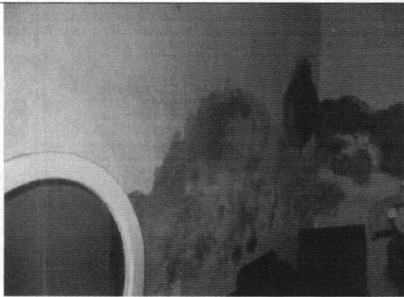
Foto 5. Humedad en muro costado norte
