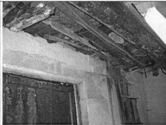
Foto 5. Agrietamientos y humedad en muro
