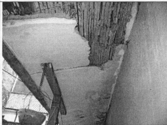
Foto 7. Daño en cielo raso y apoyo insuficiente
