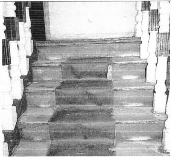
Foto 8. Escalera de acceso a segundo piso esta deteriorada pero estable al momento de realizar la visita.
