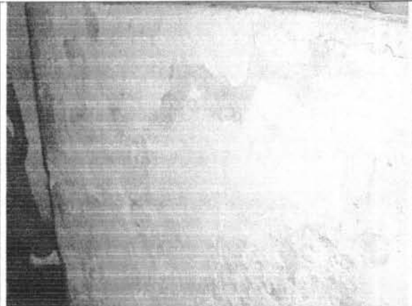
Foto 6. Muros internos deteriorados con caída de acabados.
