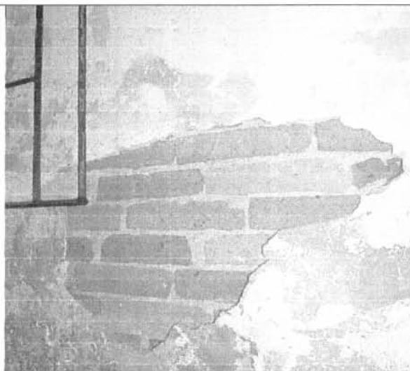
Foto 3. Deterioro progresivo de la edificación y muros con desprendimiento de pañete.
