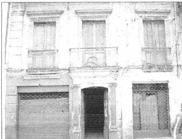
Foto 1. Condiciones de Fachada - Fisuras en los muros y desprendimiento de acabados.
