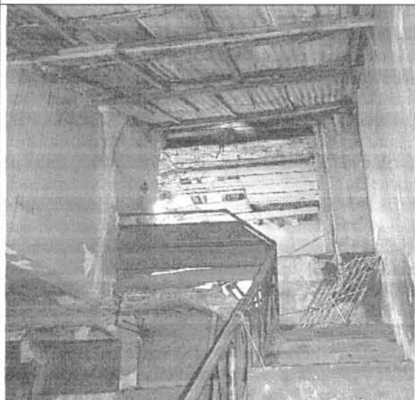
Foto 7. Deterioro interior del inmueble
