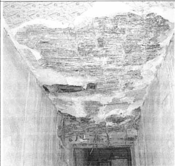
Foto 4. Corredor de acceso al inmueble, con caída de elementos del entrepiso.
