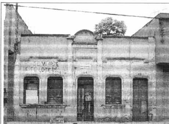
Foto 1. Condiciones de Fachada – Muros fisurados y desprendimiento de piezas de acabados.
