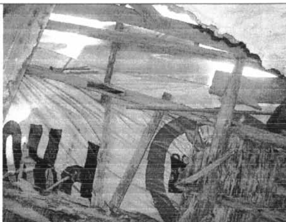
Foto 12. Colapso y deterioro de cubierta.
