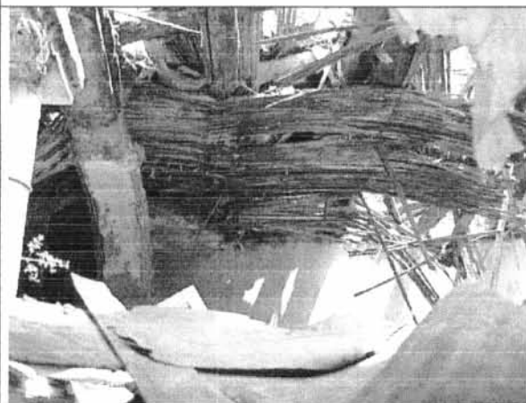
Foto 11. Colapso y deterioro de cubierta.
