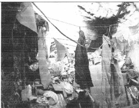
Foto 14. En algunos sectores no existe cubierta y hay acumulación de basuras en el interior del inmueble.
