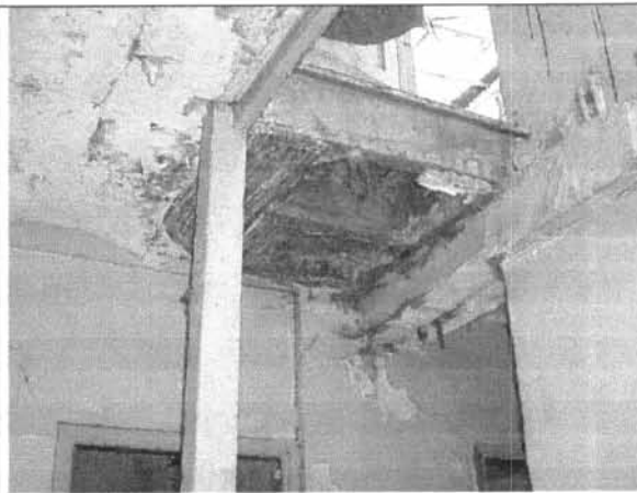
Foto 8. Colapso y deterioro de placa de piso 2
