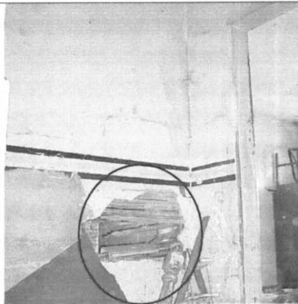
Foto 6. Desprendimiento de piezas del muro interno en segundo piso
