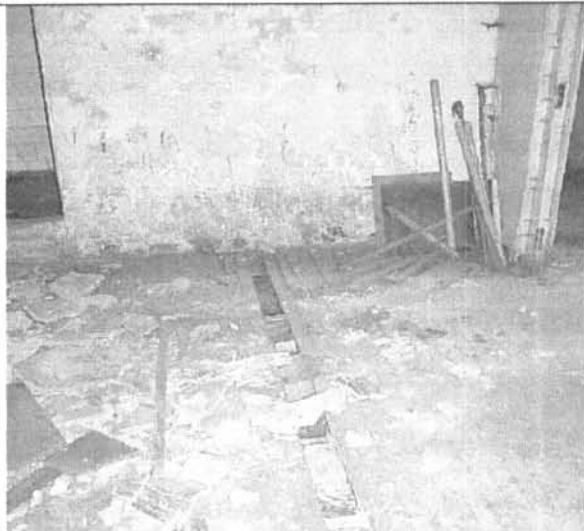
Foto 10. Caída de elementos en piso 2
