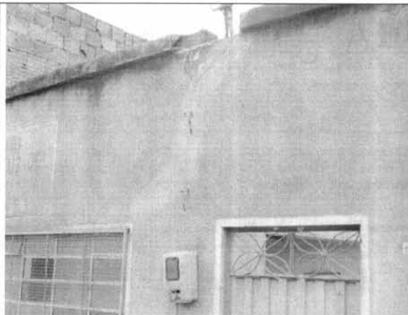
Foto 2. Agrietamiento fuerte en los muros de fachada.
