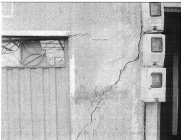
Foto 3. Detalle de las grietas en los muros de la fachada.
