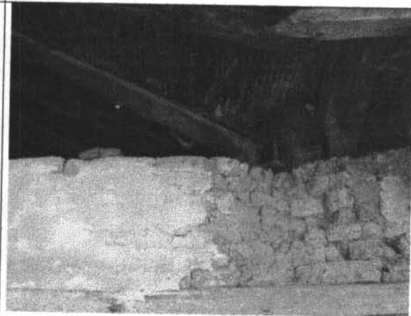
Foto 4. Muros interiores en mal estado
