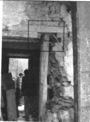
Foto 5. Estructura en mal estado
