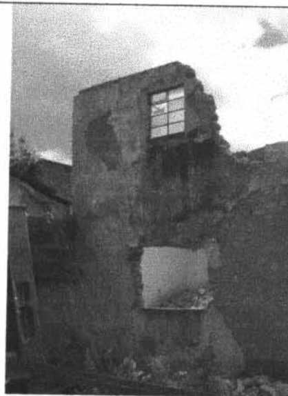
Foto 10. Fachada interior suelta por demolición
