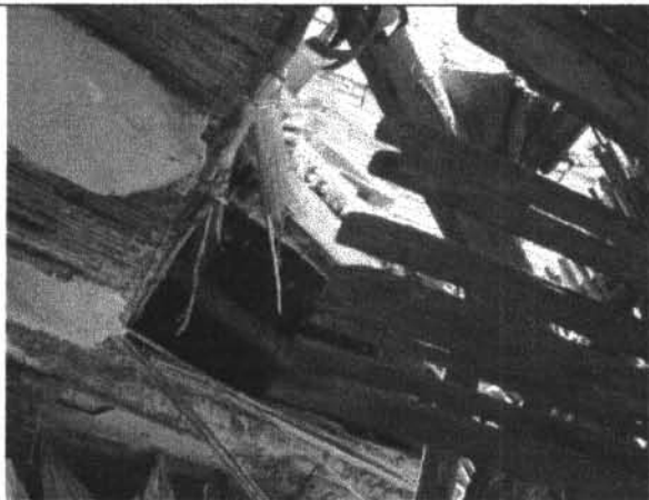
Foto 3. Colapso total de cubierta.
