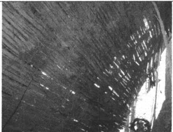
Foto 4. Colapso de la cubierta.
