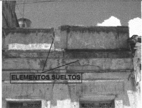
Foto 2. Elementos altos de fachada sueltos
