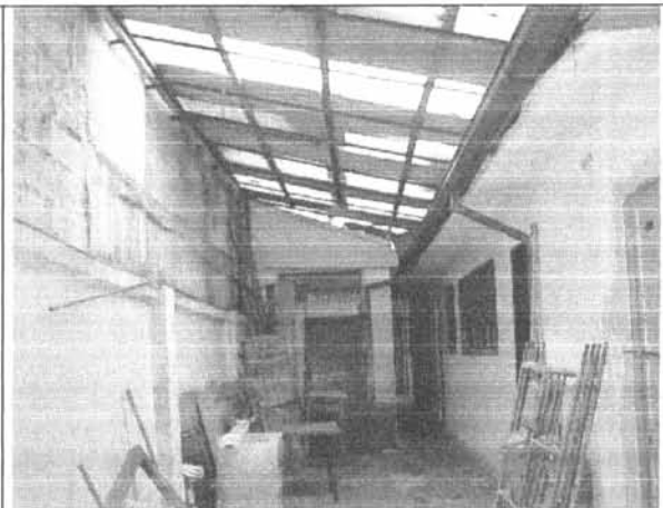
Foto 2. Estado interior del inmueble.
