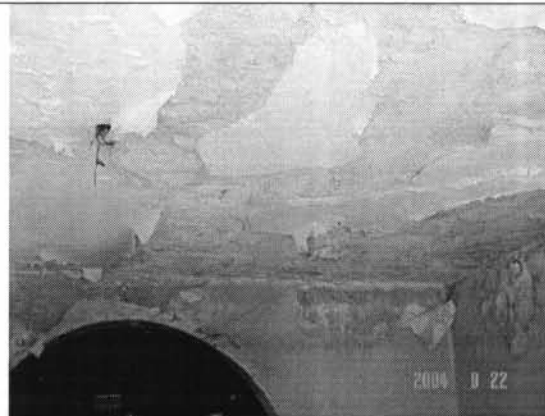
Foto 4. Deterioro de los acabados por ingreso de agua.
