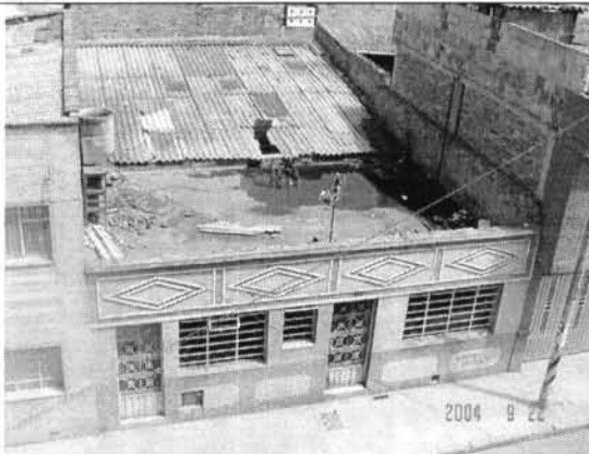
Foto 3. Vista general de la cubierta, empozamientos de agua lluvia en la placa y rotura de tejas.
