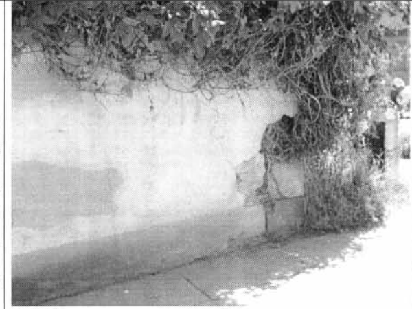
Foto 4. Detalle de la fractura en la base del muro occidental.
