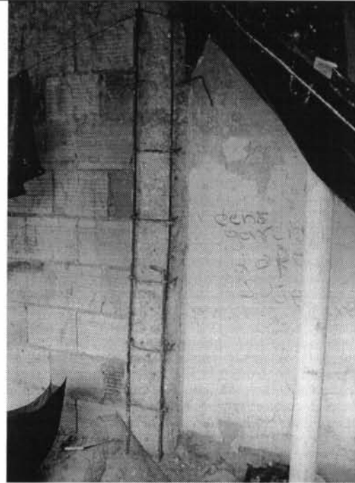
Foto 8. Columna con reforzamiento estructural sin terminar.
