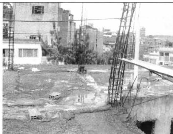
Foto 4. Placa superior en la parte anterior reforma estructural, mala impermeabilización y empozamientos
