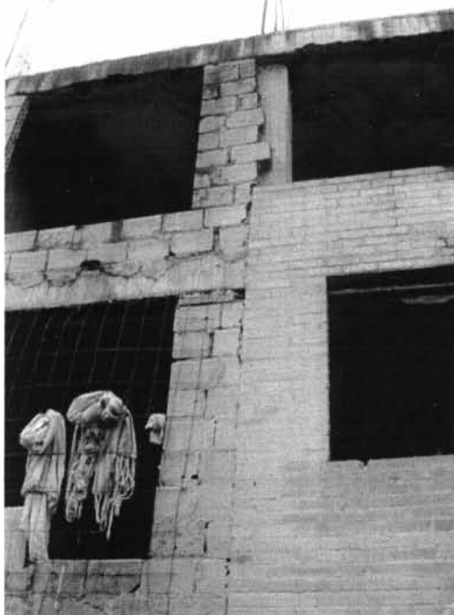
Foto 11. Estado de los muros en la parte posterior de la edificación
