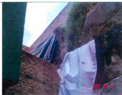
Fotografía No. 4. Aspecto del talud localizado en el costado nororiental del desarrollo, que por sus características presenta una alta susceptibilidad a presentar desprendimientos de material.
