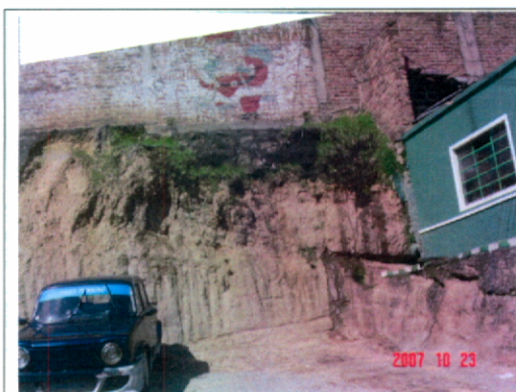
Fotografía No. 3. Aspecto del talud localizado en el costado noroccidental del desarrollo sobre la Transversal 16 I, en donde se observa la presencia de agua de infiltración proveniente de talud y la carencia de medidas de protección en el mismo.
