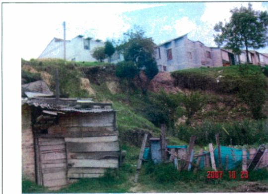
Fotografía No. 3. Aspecto del escarpe localizado en el costado occidental del lote 11A, que por sus características presenta una alta susceptibilidad al desarrollo de procesos de remoción en masa.
