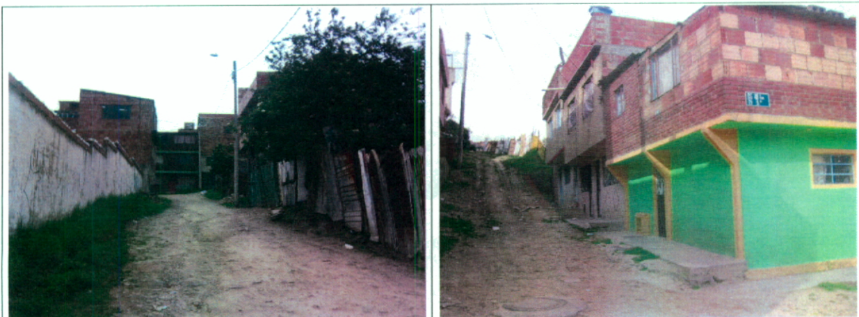
Fotografías No. 1 y No. 2 Aspecto de las vías sin pavimentar dentro del desarrollo El Mirador II. Diagonal 48 L Bis A Sur y Transversal 5W respectivamente.
