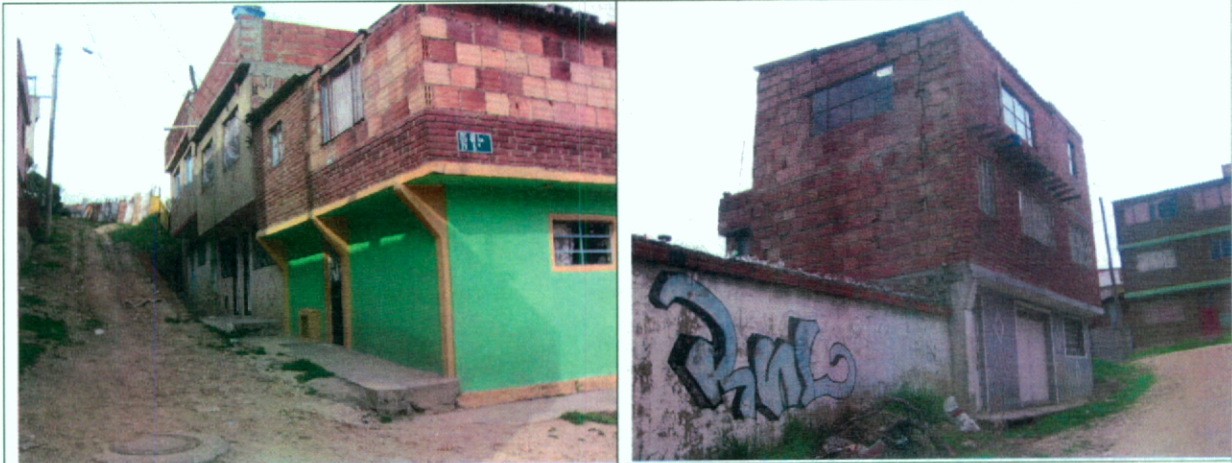
Fotografías No. 3 y No. 4. Tipología predominante de las viviendas en el desarrollo El Mirador II, que se caracteriza por viviendas en mampostería sin confinamiento estructural.
