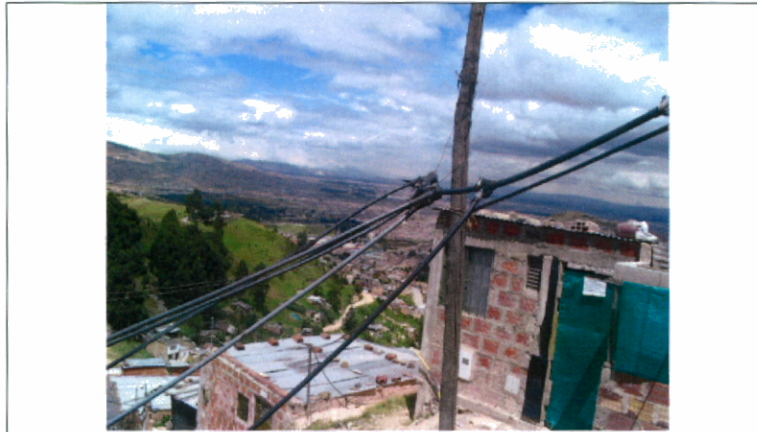
Fotografía No. 2. Detalle de las uniones de las mangueras que transportan el agua a cada predio en el desarrollo San Martín.
