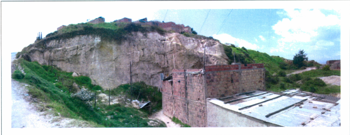
Fotografía No. 4. Vista del talud noroccidental, en el Sector 1 del desarrollo Nueva Pensilvania 2, en el cual son evidentes los problemas de erosión diferencial y el alto grado de fracturamiento de las rocas del Conjunto Superior de la Formación La Regadera.
