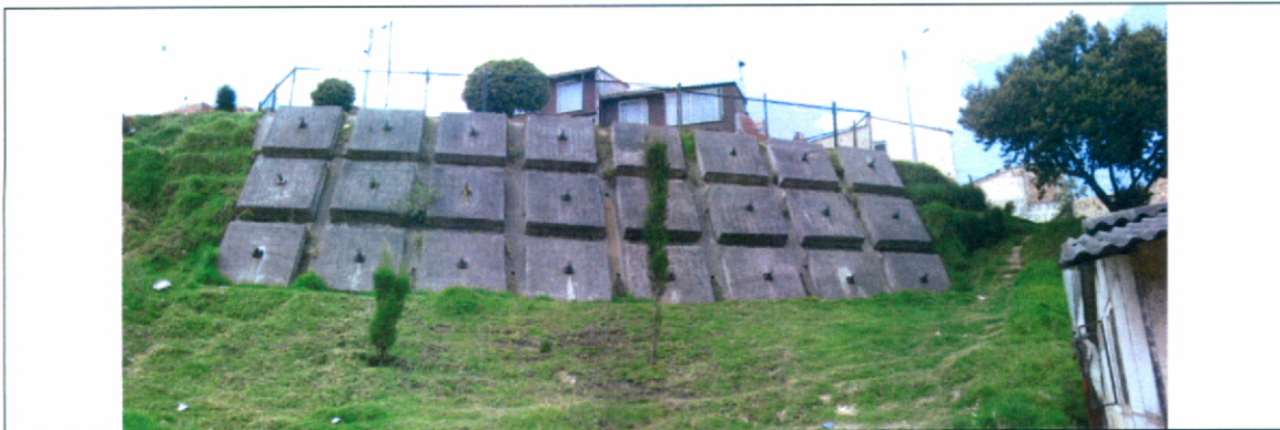
Fotografía No. 3. Talud de la parte noroccidental del Sector 4 del desarrollo Nueva Pensilvania 2 (Manzanas 9 y 10), en el cual se implementaron medidas de mitigación por parte del FOPAE.
