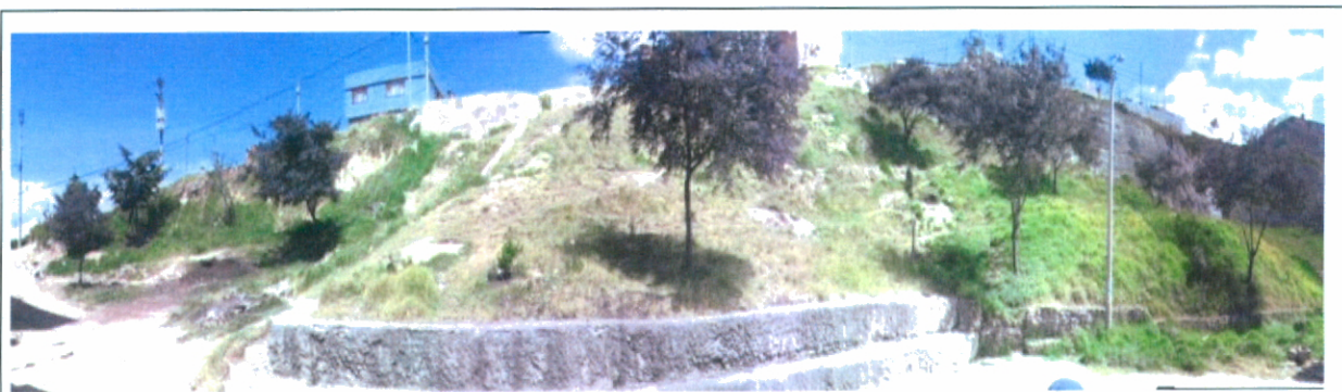
Fotografía No. 2. Talud de la parte nororiental del desarrollo (Manzanas 62 y 14), en el cual se implementaron medidas de mitigación por parte del FOPAE.
