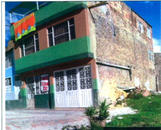
Fotografía No. 7. Tipología predominante de las viviendas en el desarrollo, que se caracteriza por construcciones principalmente en mampostería sin confinamiento y con condiciones estructurales regulares.
